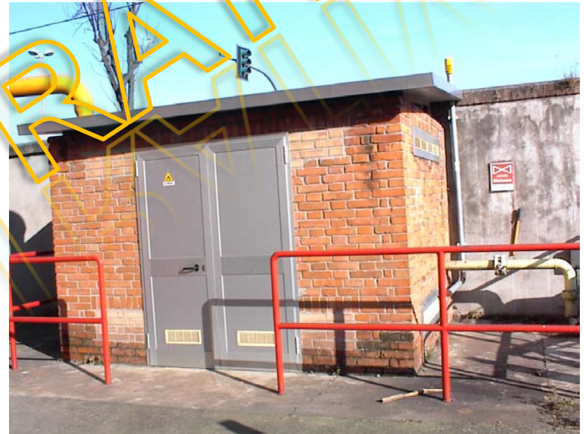
Sfiato di valvola di sicurezza
